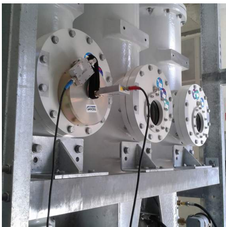
Ejemplo de sensor UHF que se ajusta a la ventana de vidrio dieléctrico circular
