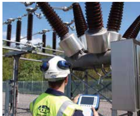
Surveillance de décharges partielles en service avec l'instrument Doble PDS100..
